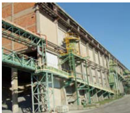
Fig. 1 - Linea di trasporto pneumatico (in alto) e linea trasporto cemento al pontile (in basso) prima della modifica. Pneumatic transport line (at the top) and cement transport line to the dock (at the bottom) before upgrading
