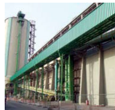
Fig. 3 - Nuovo nastro trasportatore ed elevatore a tazze - New belt conveyor and bucket elevator
